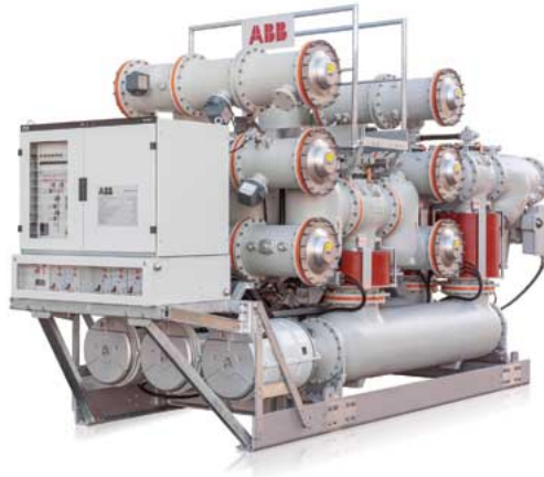
Figure 2: Kompakt 420 kV GIS ställverk från ABB B[14]
