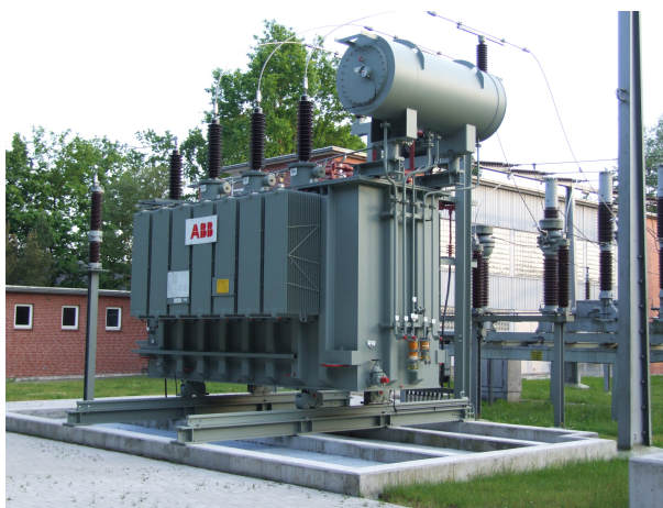
Figure 6: Transformatorstation med oljetank på toppen[9]
